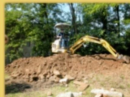
Le operazioni di rimozione della fascia di terreno di fronte all'ingresso della chiesa.
